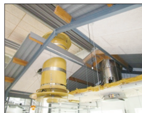
圖24 使用於家畜場域之垂直式軸流進氣通風設備
