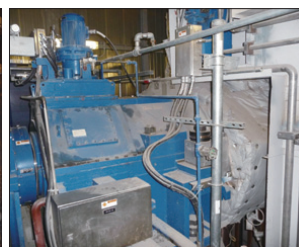
圖18 FibroMinn發電廠蒸汽渦輪機
