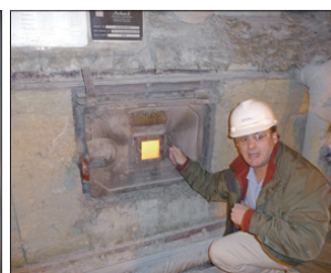
圖22 FibroMinn發電廠焚化爐內燃燒觀察窗
