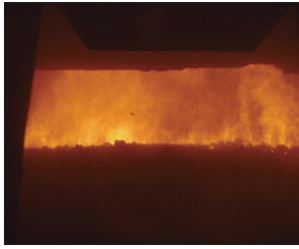
圖23 FibroMinn發電廠焚化爐內燃燒情形 (觀察窗向內拍攝)
