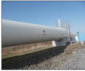
圖24 FibroMinn焚化爐啟動燃料儲丙烷存槽及控制設施
