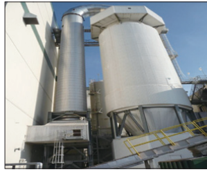
圖25 FibroMinn焚化爐排煙處理及過濾設施
