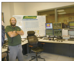
圖15 FibroMinn發電廠中央控制室及控制人員
