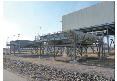
圖4 美國 FibroMinn雞糞發電廠之鍋爐蒸汽冷凝散熱裝置
