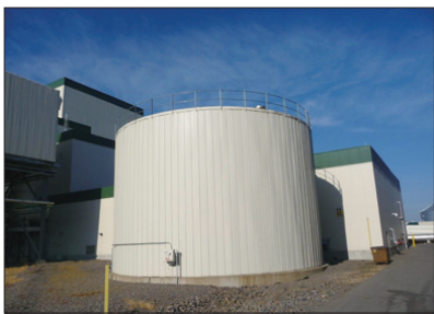
圖5 發電廠內之消防用水儲存塔
