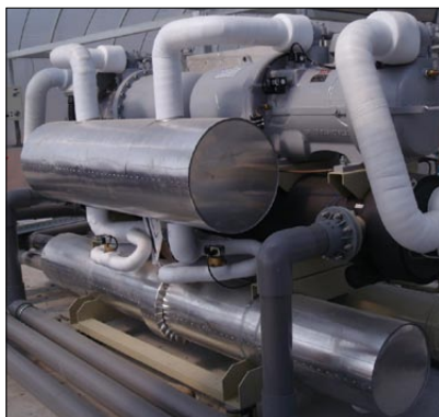
圖8 農試所花卉中心40噸熱泵主機
