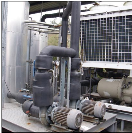
圖13 科隆國際公司熱泵主機
