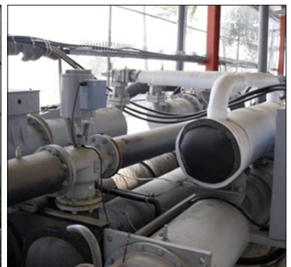
圖10 世芥蘭業之熱泵主機
