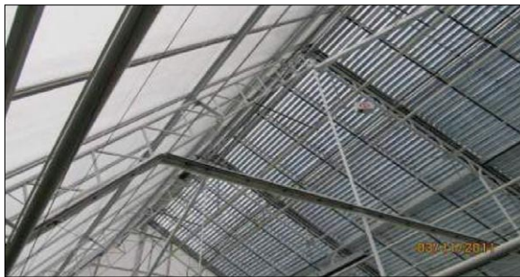
圖13 溫室屋頂百葉板太陽能加熱管路
