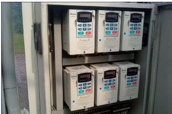
圖2 花卉中心負壓風扇變頻電控箱
