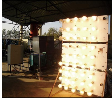
圖10 燃燒爐發電試驗
