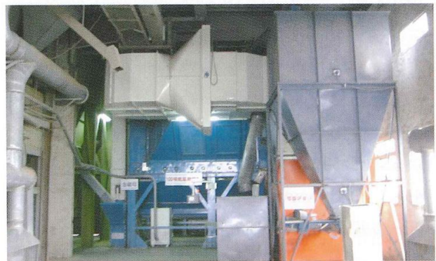
三升公司粗糠燃燒爐
