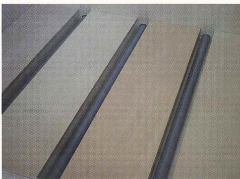
(5) 醱酵槽送風管
