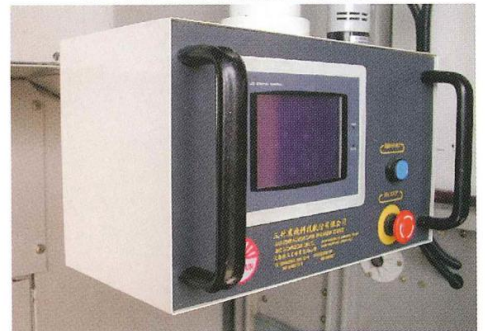
PLC 控制系統/觸控銀幕
