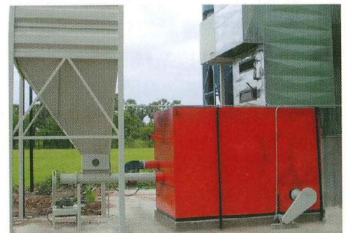
粗糠燃燒爐/熱交換式熱源
