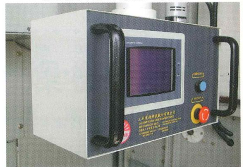
PLC 控制系統/觸控銀幕
