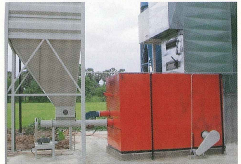
粗糠燃燒爐/熱交換式熱源
