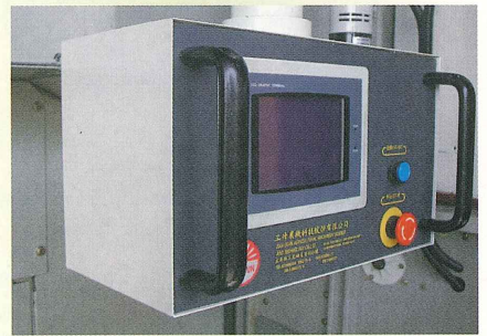
PLC 控制系統/觸控銀幕
